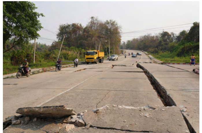
Das Erdbeben hat sogar die Straße aufgerissen. Foto: Aung Shine OoAP/dpa
